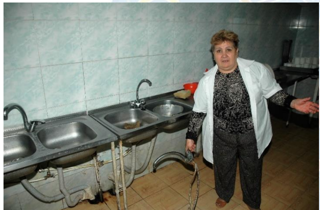
Jedes Mal wenn wir dort sind, gibt es araturen zu machen. Die Küche stand unter Wasser, Schläuche und ersetzt werden. Nicht mal für das
